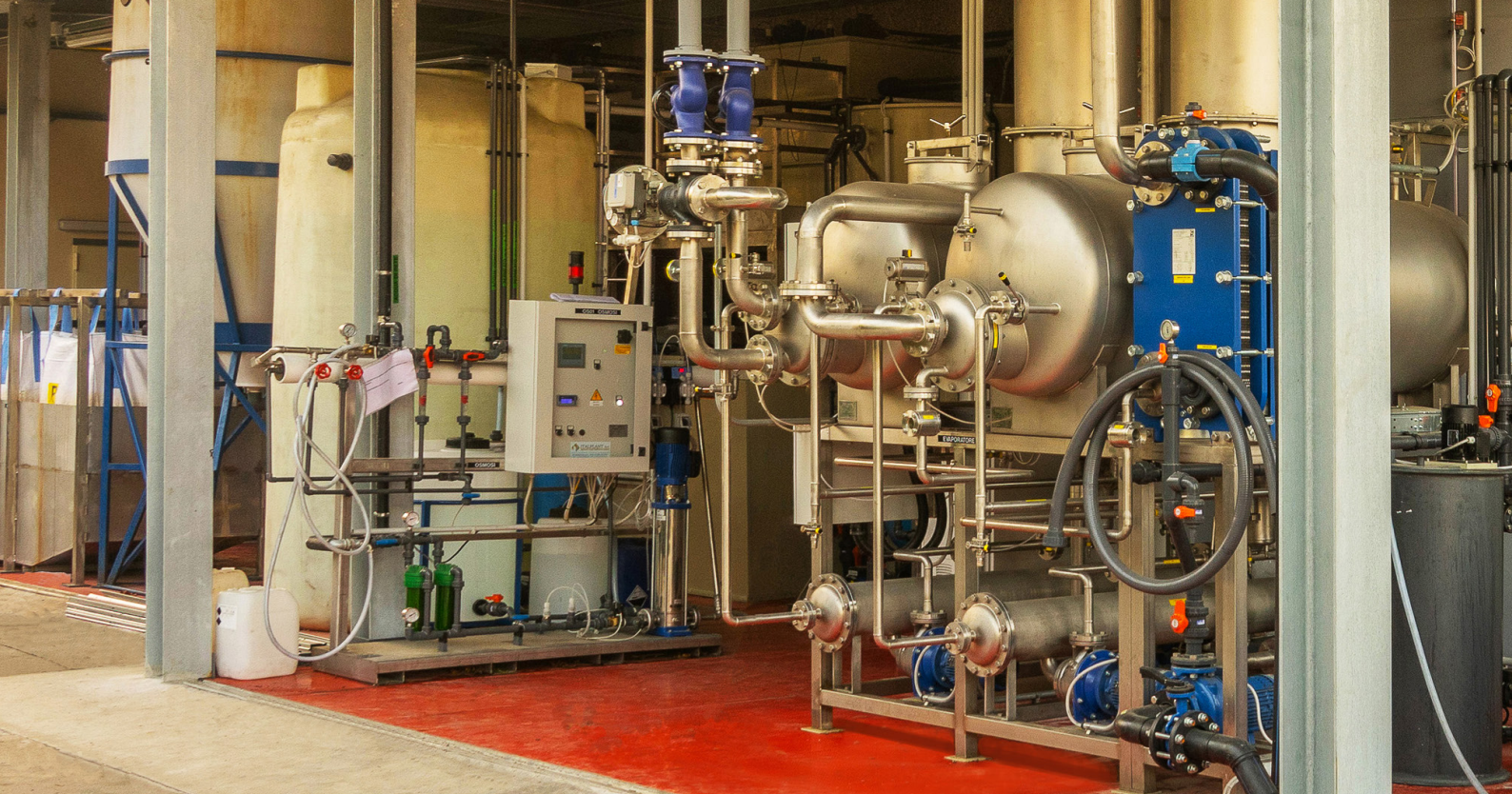
Sistema di trattamento acque
